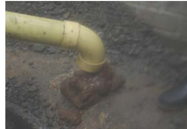
Sedimentos del vertimiento que se colmatan y obstruyen la tubería si no se realiza mantenimiento
