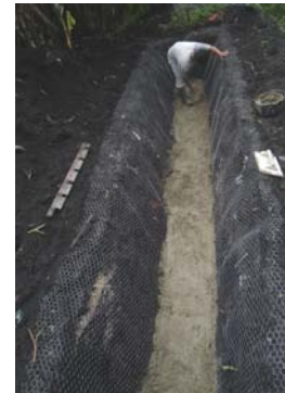
Implementación canal de aireación
