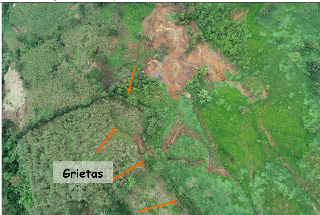
Imagen 4. Grietas parte alta del talud – Corona deslizamiento.
