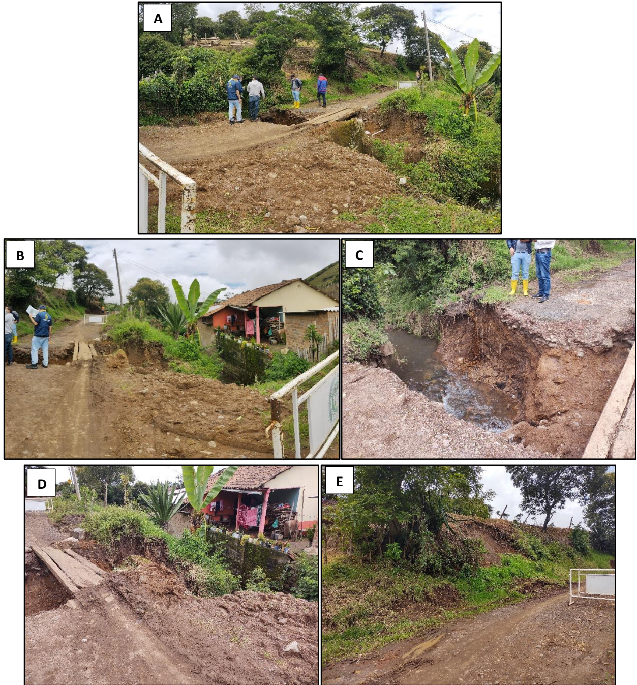
Figura 11. A – D. Perdida de banca y socavamiento profundo de la fuente hídrica. E. Deslizamientos sobre la ladera.
