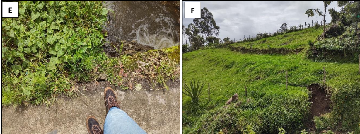
Figura 9. A. Erosión base del puente. B–C. Desprendimiento parcial de la estructura del puente “box couvert” y erosión lateral. D. Movimientos en masa en taludes de la zona. E. Agrietamiento en carretera. F. Movimientos del terreno (reptación y escalonamiento).
