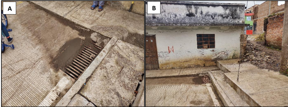
Figura 3. A. Alcantarilla tapada por sedimentos transportados. B. Viviendas afectadas por la inundación.
