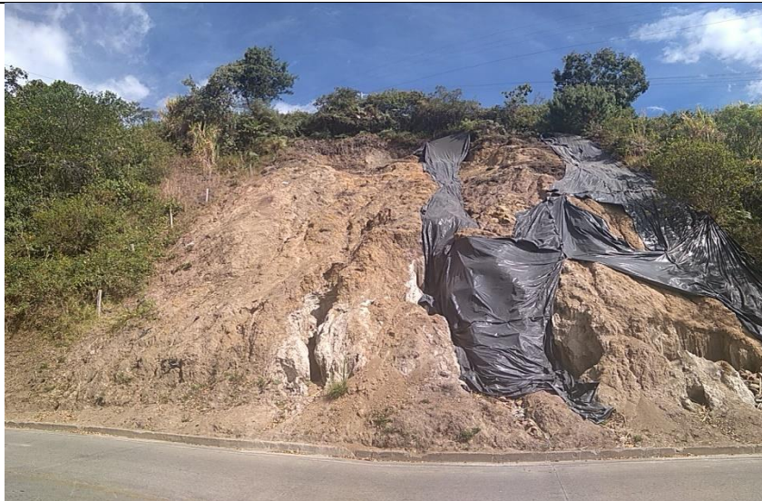
Imagen 1. Deslizamiento vía casco urbano del municipio de San Pedro de Cartago.
