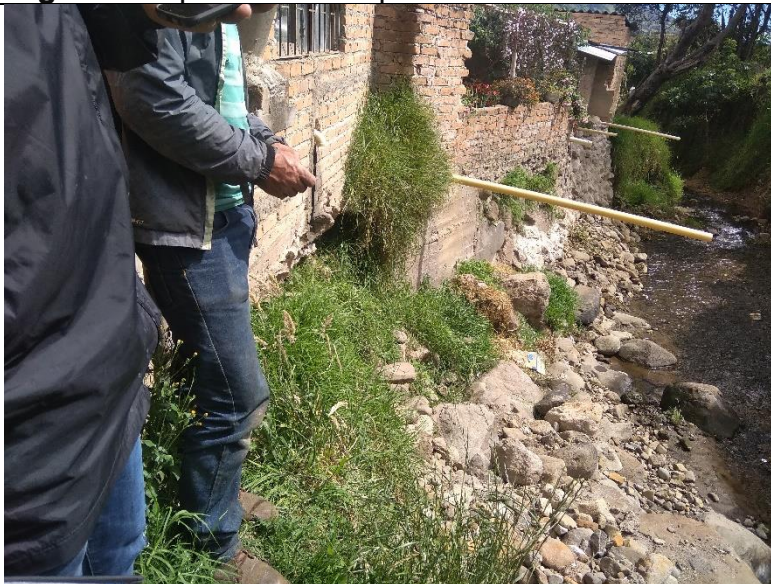
Imagen 5. Depósitos de la quebrada – taludes inestables.
