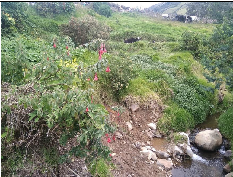
Imagen 2. Filtraciones de agua al pie del talud.
