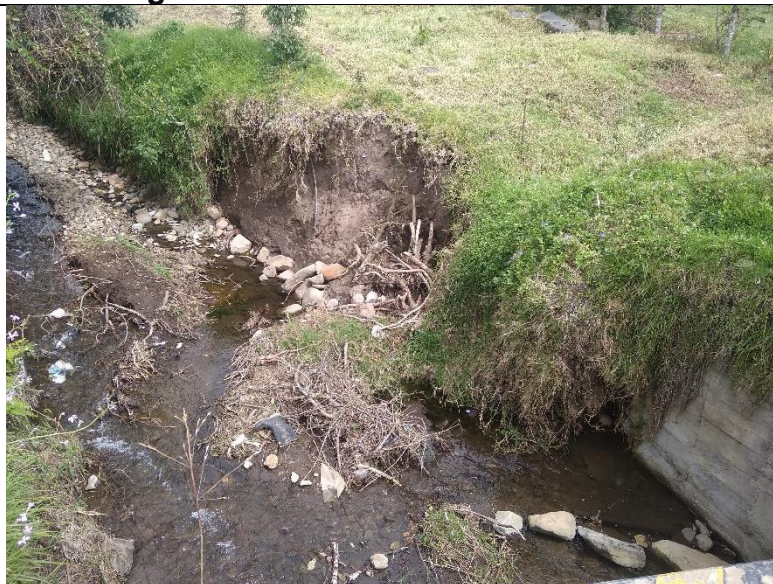
Imagen 6. Deslizamientos sector El Rosal.
