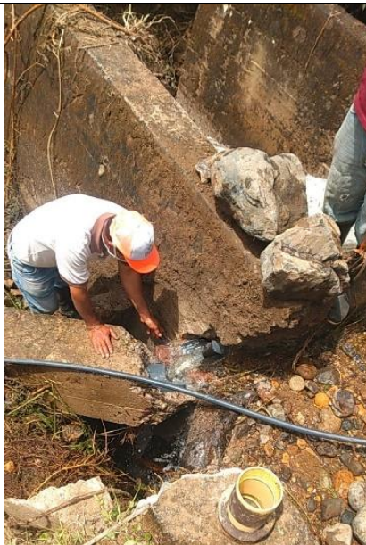
Imagen 3. Daños en estructura del acueducto.
