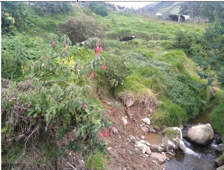
Imagen 2. Filtraciones de agua al pie del talud.
