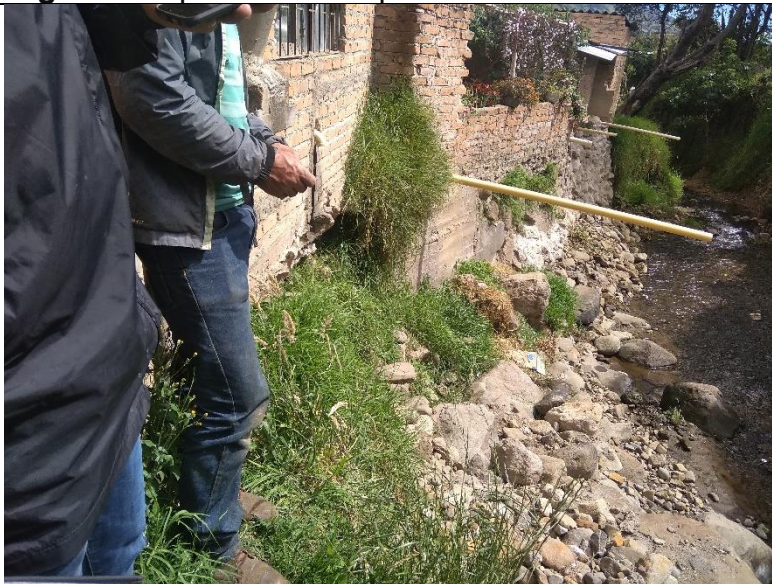
Imagen 5. Depósitos de la quebrada – taludes inestables.
