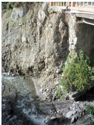
FOTOGRAFÍA 33. Estribo de salida derribado por la avalancha. Obsérvese la situación del talud aguas abajo.
