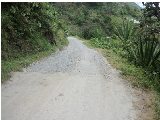
FOTOGRAFÍA 15. Vía San Bernardo – San José de Alban. N1003019, E659329. Presencia de grietas y asentamientos de calzada en época invernal.
