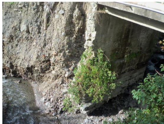
FOTOGRAFIA 34. Socavación de la cimentación del estribo derecho.
