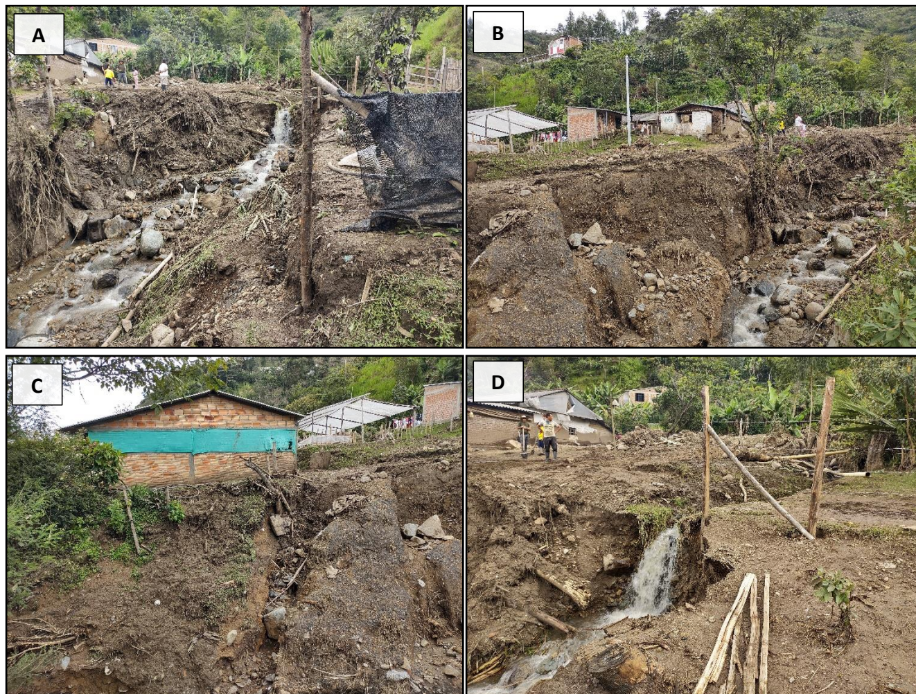
Figura 5. A-D. Socavación de lecho de la fuente hídrica, erosión lateral taludes inestables.
