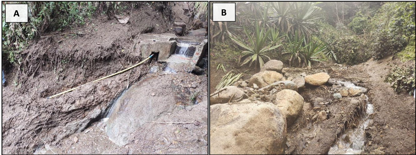
Figura 8. A. deslizamientos sistema de captación de agua acueducto Sector Los Castillos. B. Deslizamientos parte alta de fuentes hídricas.
