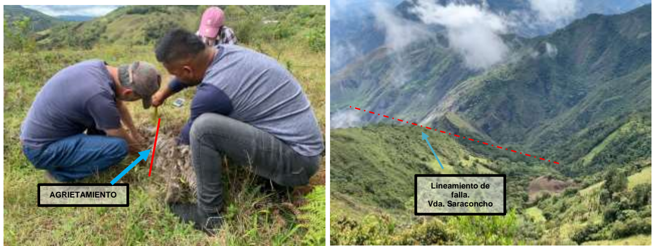
Figura 2. A. Agrietamiento–. B. Geomorfología de la zona.
