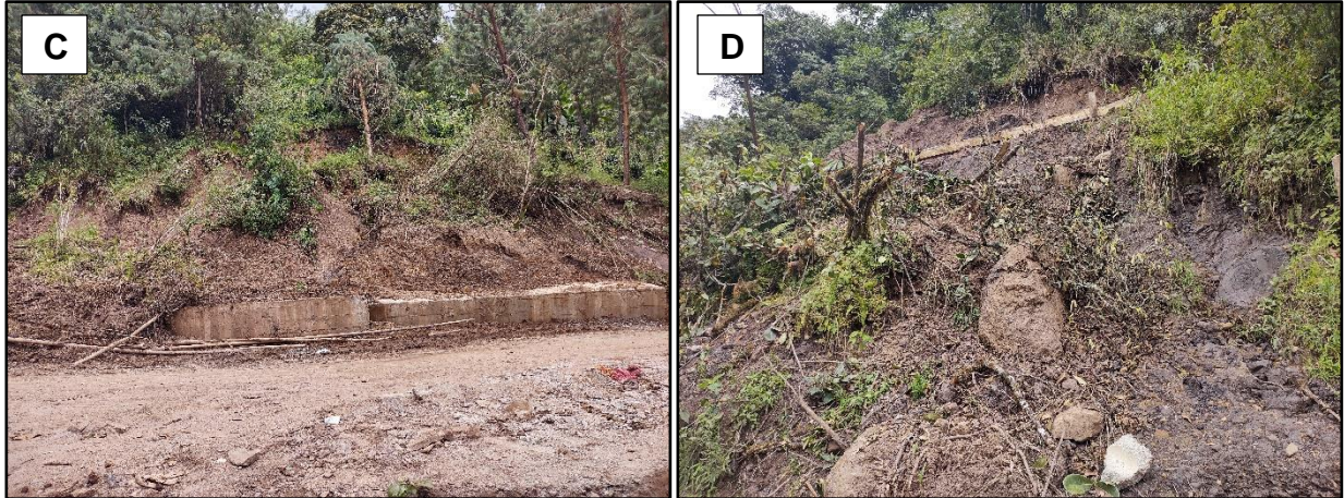
Figura 2. A. Vista del puente provisional en madera y restos de la estructura del puente en la quebrada. B. Restos de la estructura del puente que se destruyó. C. Deslizamientos en la vía que comunica al puente La Rogelia D. Restos de escombros de los deslizamientos que afectan a la quebrada.
