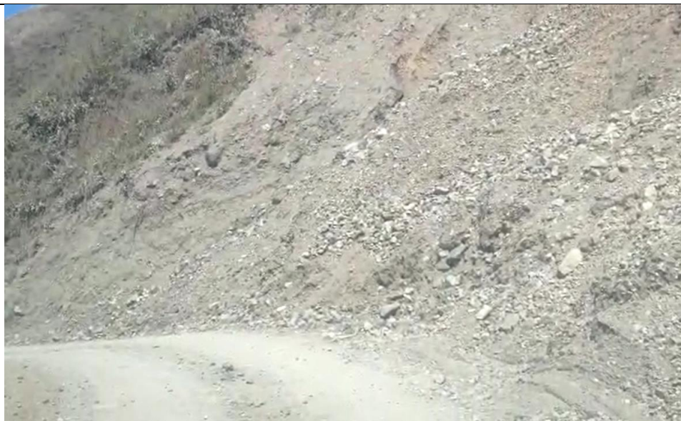
Imagen 3. Deslizamiento vía Sotomayor.
