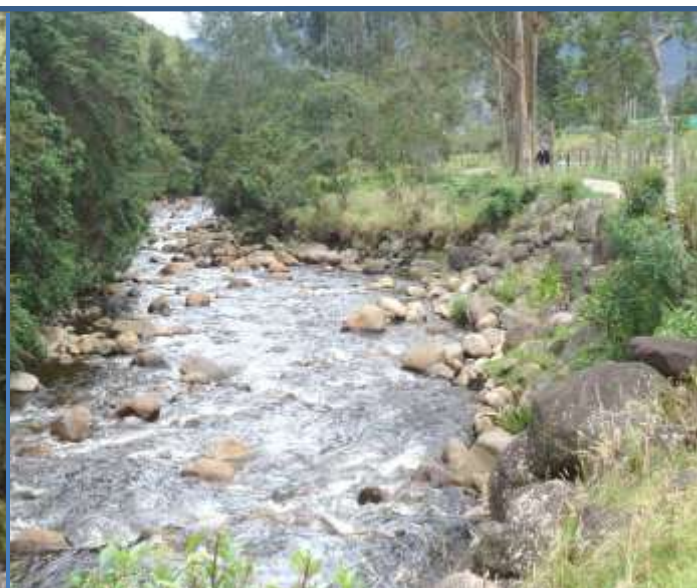
Figura 44. Vía afectada por socavación lateral producida por el Encano.
