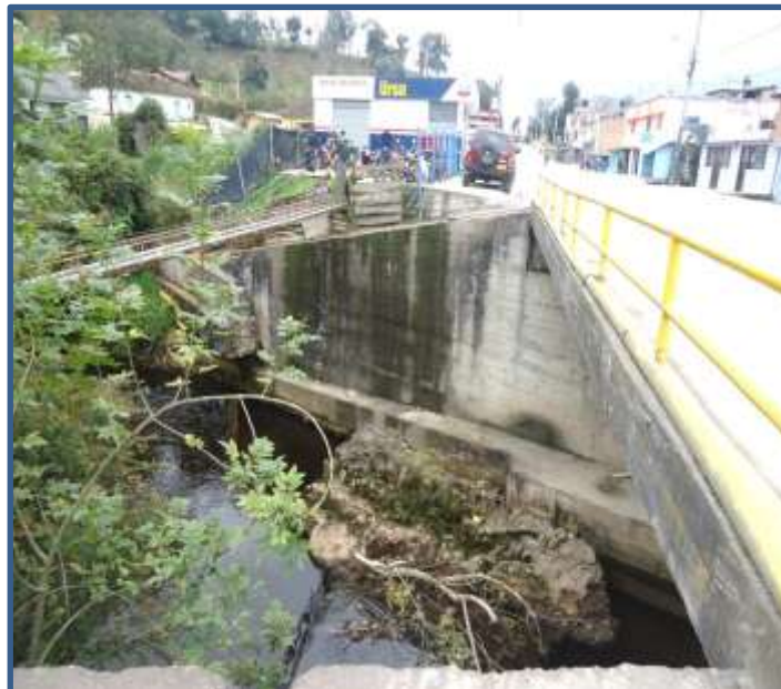
Figura 43. Puente sector El Encano, destruido anteriormente por avenida torrencial.
