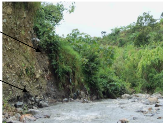
Fotografía No 2 Socavamiento de talud
