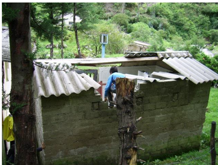
Fotografía 8. Baños del Centro Educativo Moncayo, destruidos por caída de rocas de la parte alta del talud.
