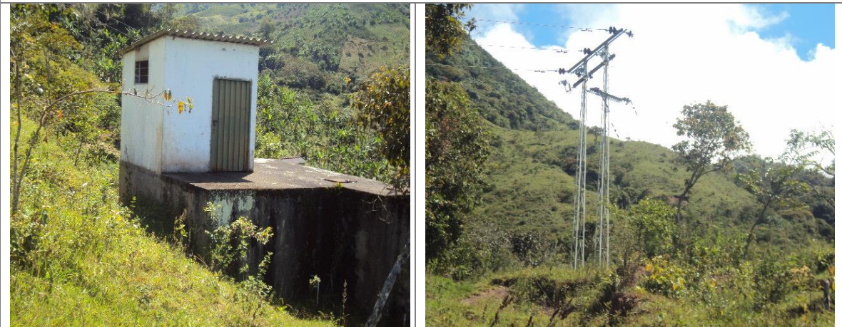
Tanque de almacenamiento
