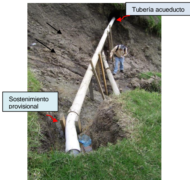
Fotografía 2. Tubería del acueducto municipal afectada por el deslizamiento.
