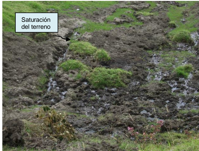
Fotografía 5. Observar la saturación del terreno, ocasionada por el ausente manejo del agua que aflora en la parte media del talud inestable.
