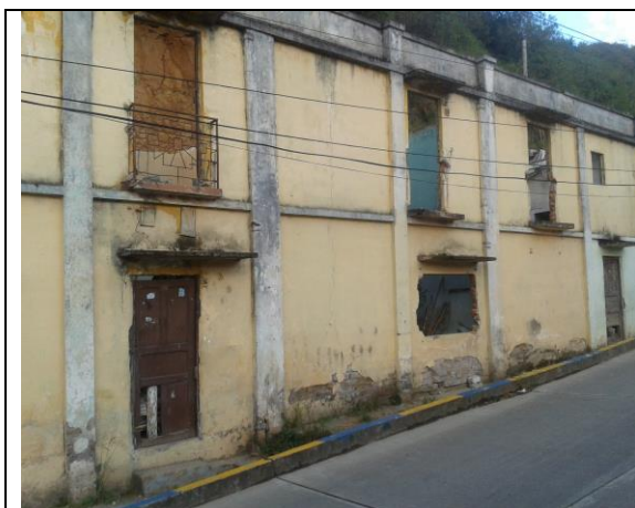
Vivienda arrasada por deslizamiento, propiedad de la Sra. Rosaura Portilla, en el momento esta reubicada
