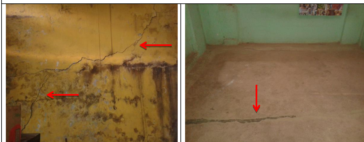
Fisuras y presencia de humedades en las viviendas de las señoras Ligia Gomez y Luz Marina Bastidas, respectivamente.
