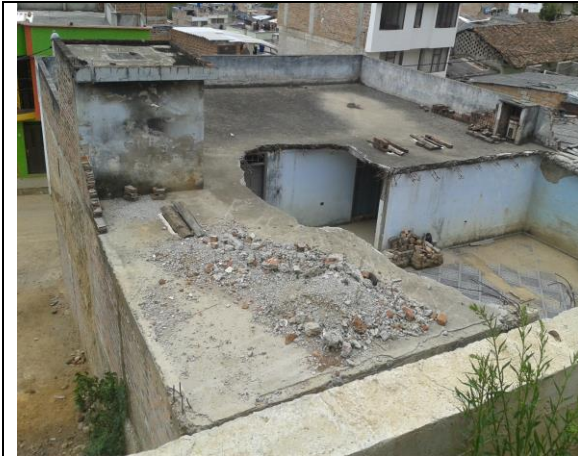
Colapso total de una vivienda producto de un deslizamiento.
