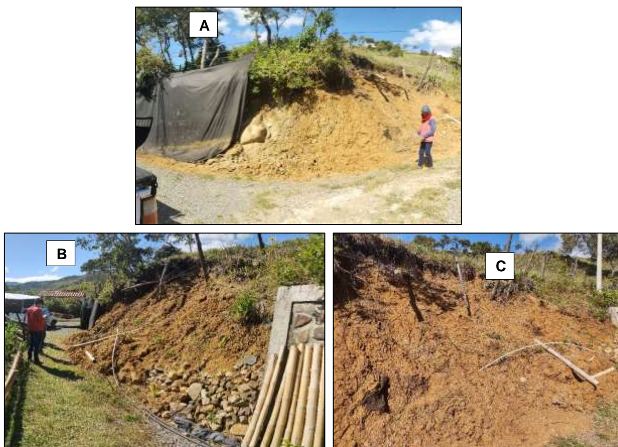
Imagen 1. A. Vista frontal deslizamiento predio El Mirador. B. Vista lateral deslizamiento predio El Mirador. C. Vista material – suelo residual deslizamiento.
