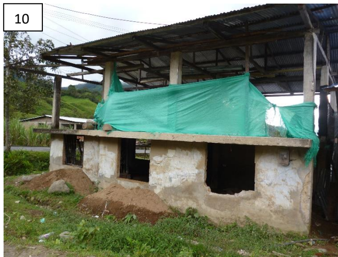
Imagen 10. Casa deshabitada afectada por el evento.
