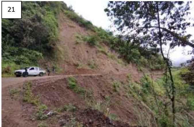
Imagen 21. Fotografía donde se evidencia material poco consolidado generando la pérdida e inestabilidad de banca de la vía.
