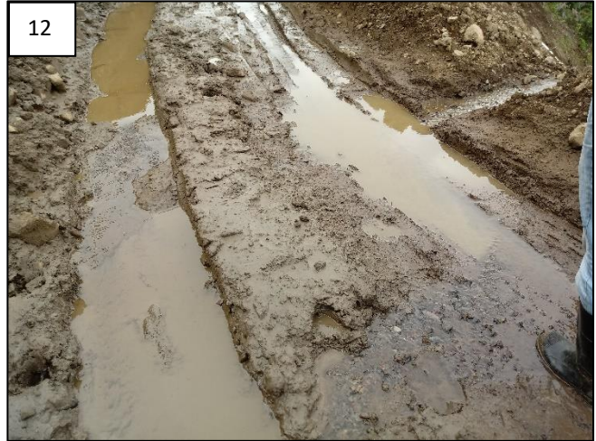
Imagen 12. Estancamiento e inadecuado manejo de aguas lluvia.
