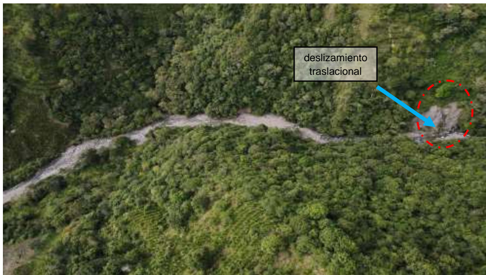
Zona que presenta, Deslizamiento traslacional a lo largo del cauce de la quebrada
