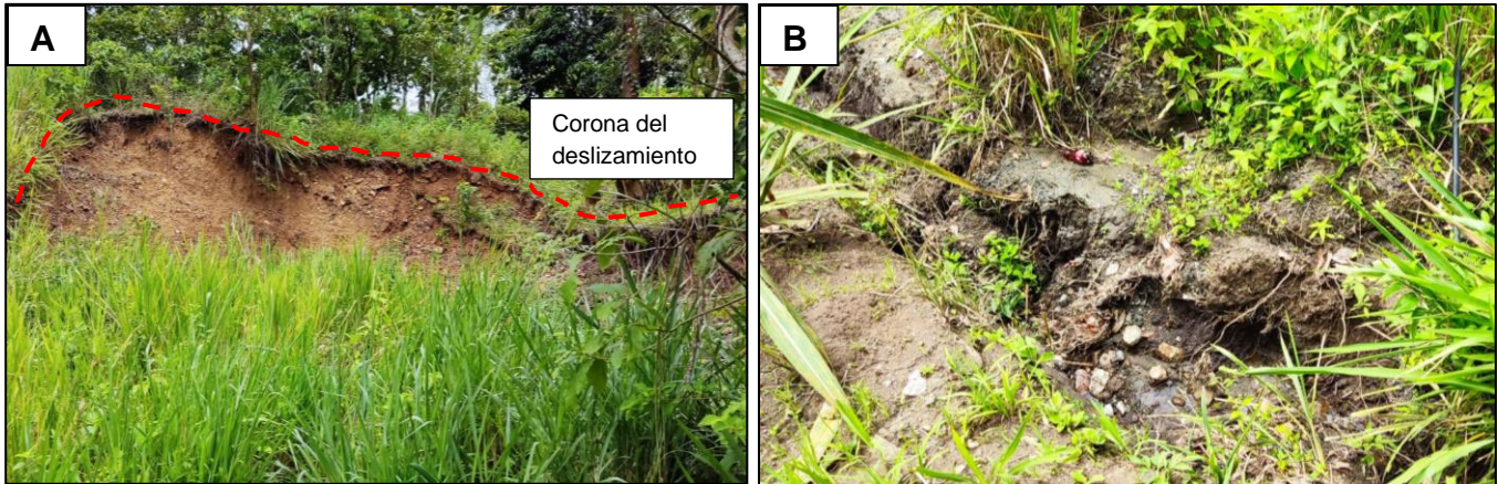
Figura 14. A. Corona de deslizamiento tipo rotacional debido al inadecuado manejo de aguas superficiales, sector cercano al tanque de almacenamiento del acueducto de la cabecera urbana, planta de tratamiento de agua potable. B. Grietas y hundimiento de aproximadamente 10 cm debido a la carga de agua y el inadecuado manejo de las mismas.
