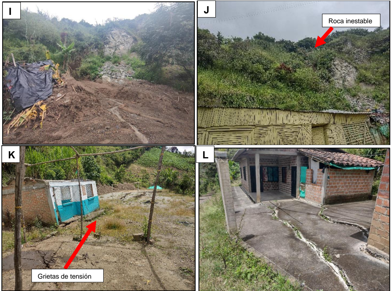
Figura 9. A-B-C-D. Pérdida de banca de la vía que conduce desde el casco urbano a las veredas Piedra Larga y Cocha Blanca. E-F-G. Viviendas en condición de riesgo con indicios de fracturamiento estructural. H. Afloramiento de agua sobre el talud y paso de la manguera del acueducto Piedra Larga. I-J. Parte baja del deslizamiento, donde se pueden presentar avenidas torrenciales y caídas de rocas. K- Grietas de tensión sobre una cancha de futbol y el volcamiento de una vivienda en la zona. L. Vivienda con agrietamientos en pisos, lo cual indica el avance de la inestabilidad en el área.
