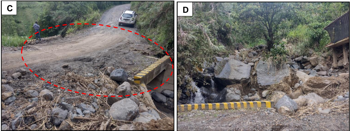
Figura 12. A. Vista general del cauce, se observan altas pendientes y deslizamientos en los taludes marginales de la quebrada. B-C-D. Box culvert construido recientemente en la vía que conduce de Ancuya a Sandoná y depósitos que evidencian alta torrencialidad.
