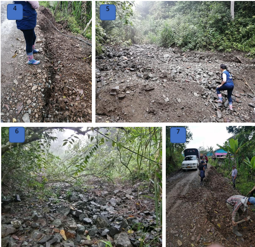
Figuras. 4,5,6,7. Afectación vereda Chilcal evidencia de avenida torrencial y pérdida de banca, municipio de La Florida.
