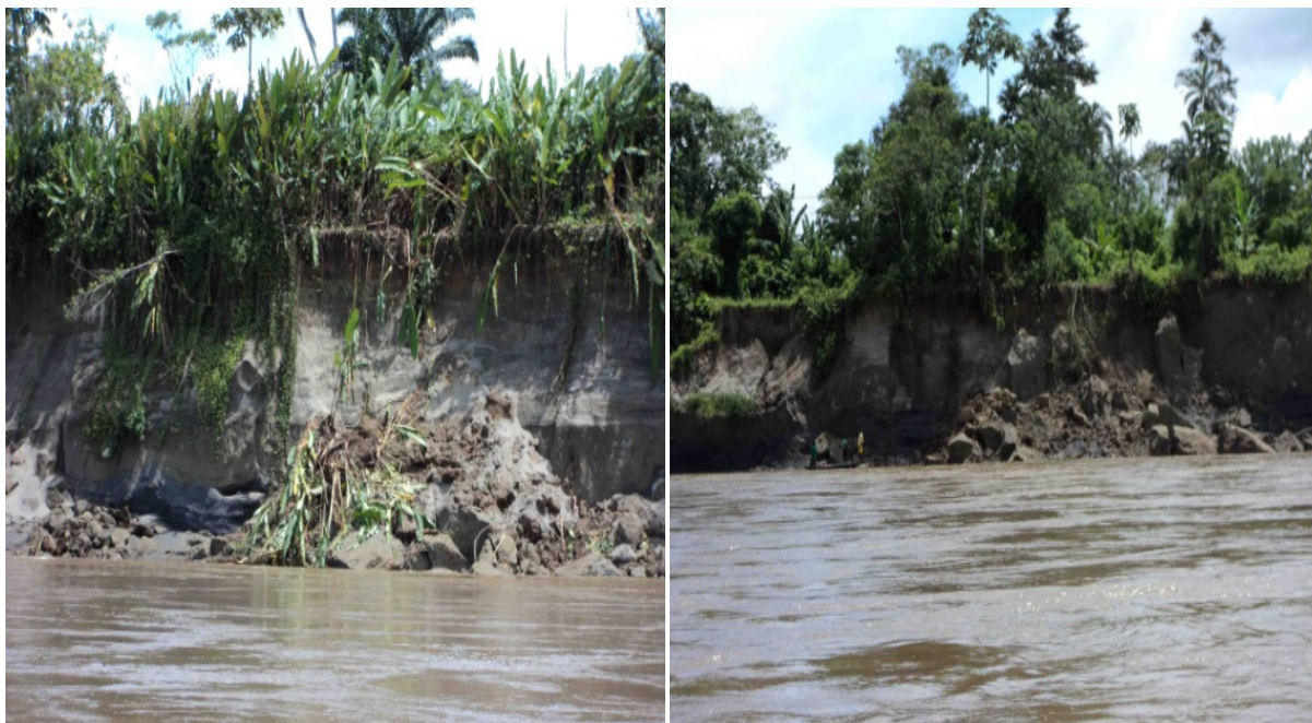
Figura 56. Procesos de socavación lateral río Mira sector Imbilí Candelillas municipio de Tumaco.
