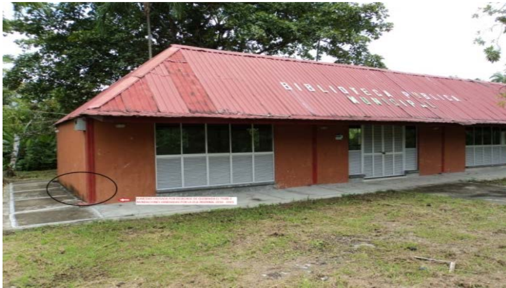
Figura 44. Infraestructura afectada sub-zona 2 biblioteca municipal de Olaya Herrera
