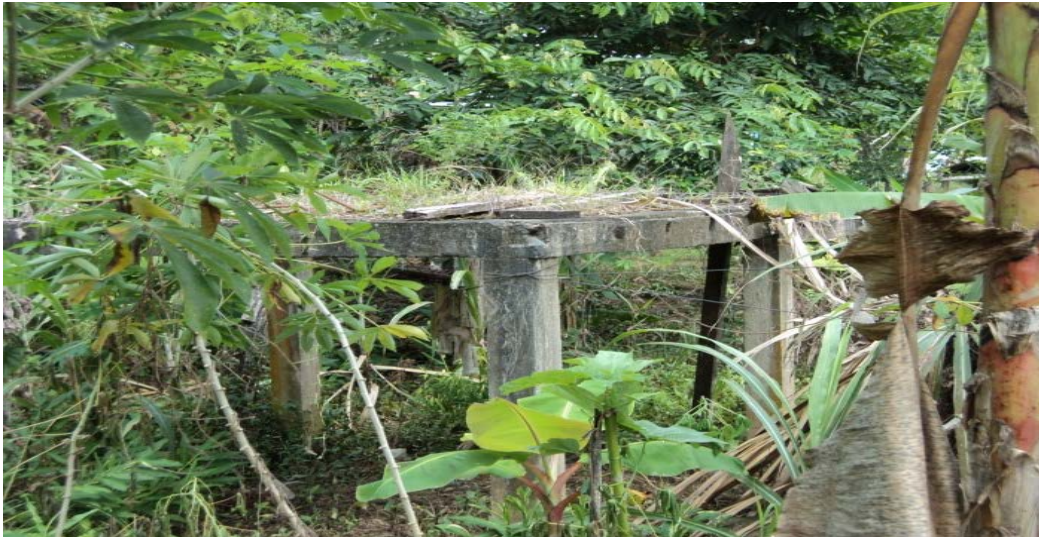
Figura 63. Infraestructura escuela de la vereda Achotal sector Imbilí Candelillas municipio de Tumaco.
