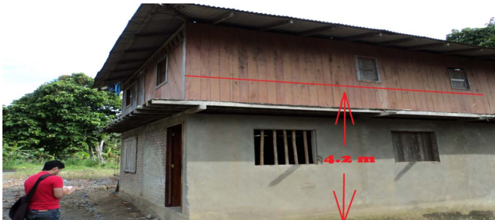
Figura 54. Marca de inundación sector Panal evento del 16 de febrero del 2009 municipio de Tumaco.
