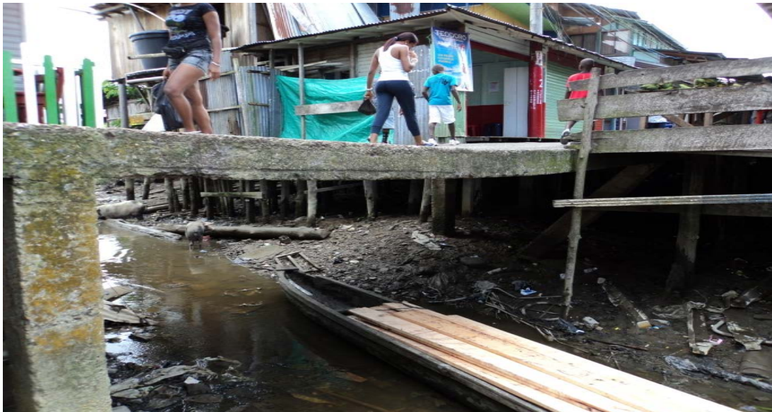
Figura 47. Infraestructura afectada sub-zona 3 puente peatonal municipio de Olaya Herrera
