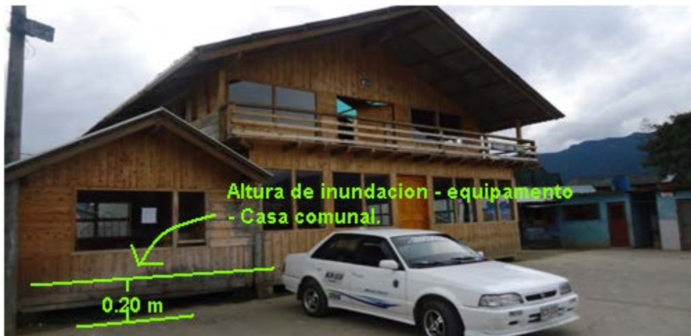
Figura 110. Estado infraestructura, casa comunal, corregimiento El Encano, municipio de Pasto.
