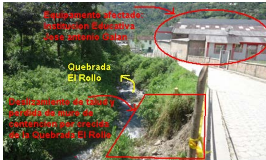
Figura 92. Estado actual Perdida de banca y muro de contención- Sector institución Educativa José Antonio Galán municipio de San Bernardo.
