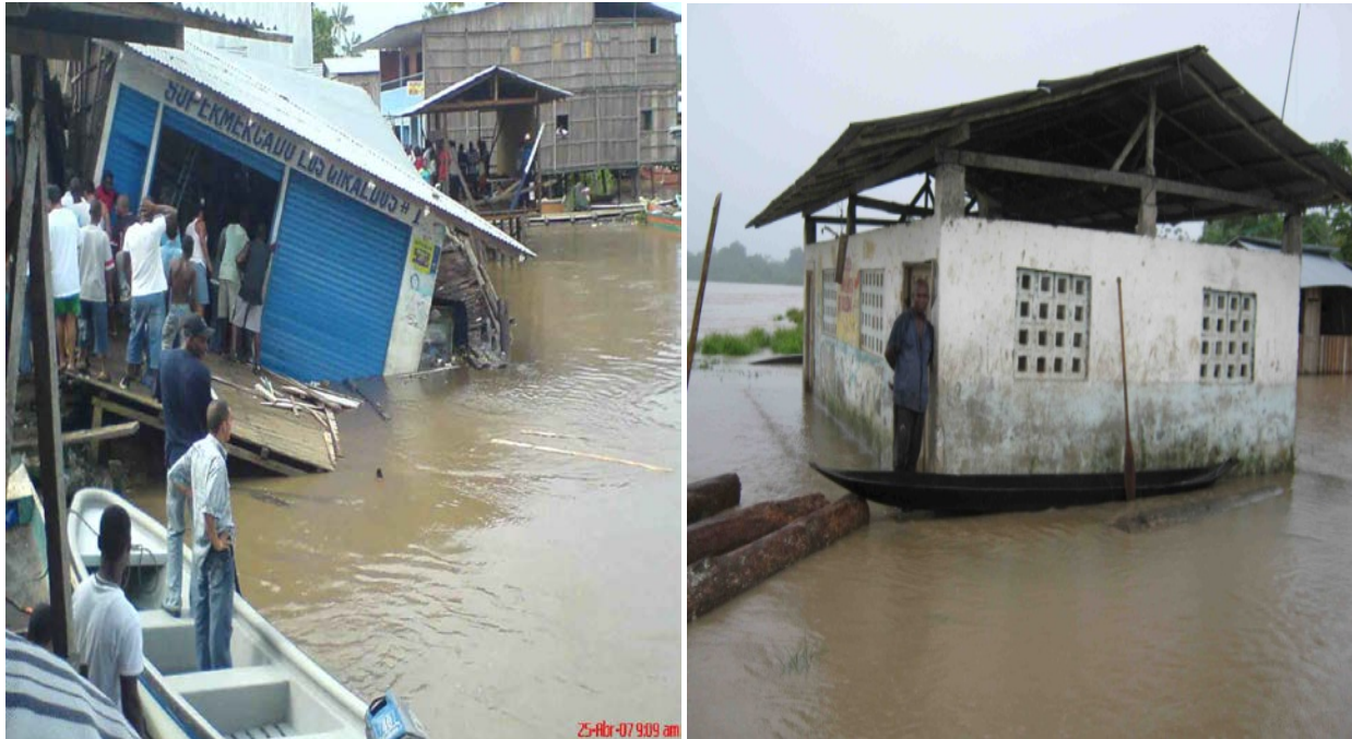
Figura 36. Afectación por socavación lateral municipio de Olaya Herrera Fuente: CLOPAD.
