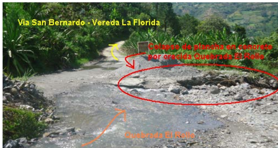
Figura 91. Estado actual Vía vereda la Florida municipio de San Bernardo
