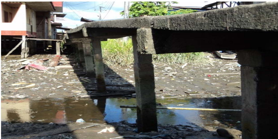
Figura 48. Infraestructura afectada sub-zona 4 puente peatonal municipio de Olaya Herrera
