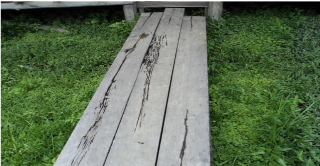
Figura 46. Infraestructura afectada sub-zona 3 caminos peatonales municipio de Olaya Herrera
