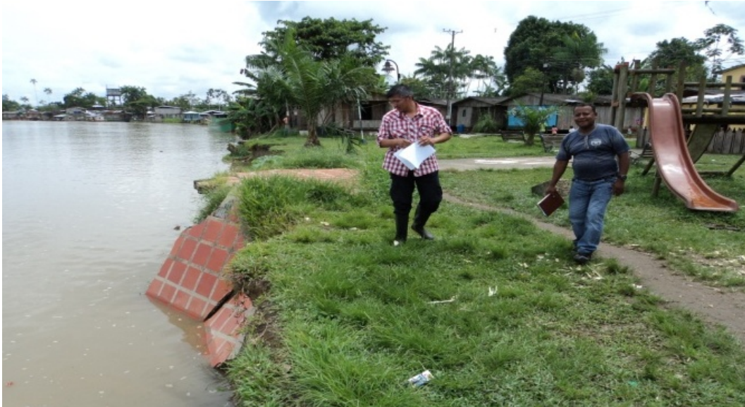
Figura 42. Infraestructura afectada sub-zona 1 municipio de Olaya Herrera
