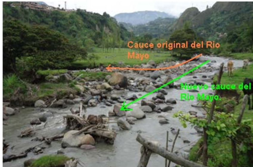
Figura 100. Estado infraestructura predios sector Vega Quito, municipio de San Pablo.
