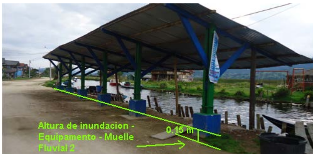
Figura 111. Estado infraestructura, muelle fluvial, corregimiento El Encano, municipio de Pasto.
