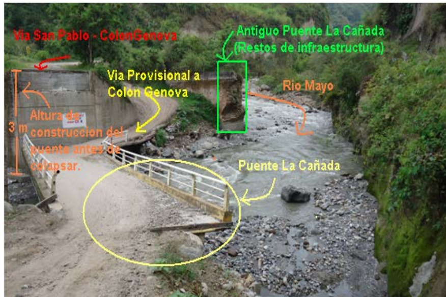
Figura 99. Estado infraestructura puente La Cañada, municipio de San Pablo.
