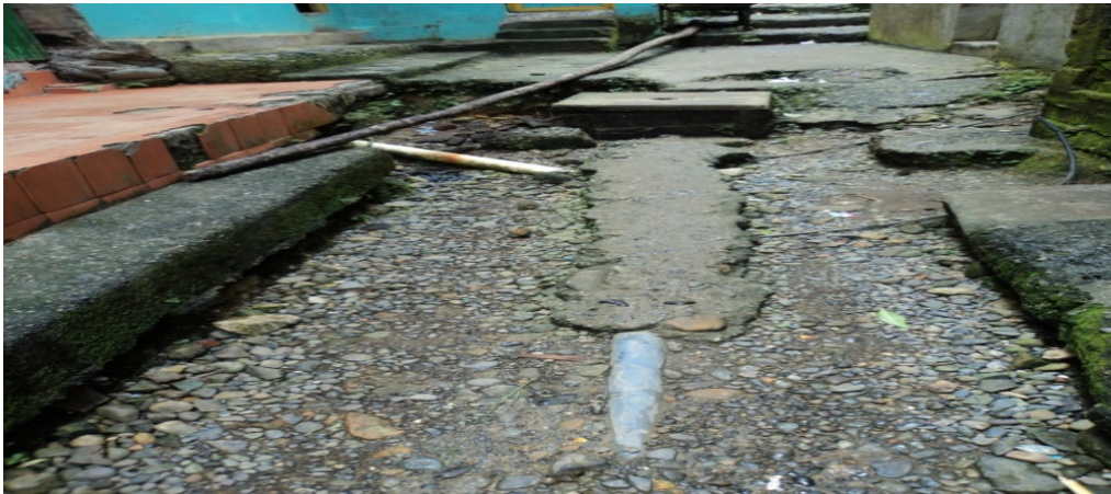
Figura 77. Infraestructura tuberías cabecera municipal de Barbacoas.
