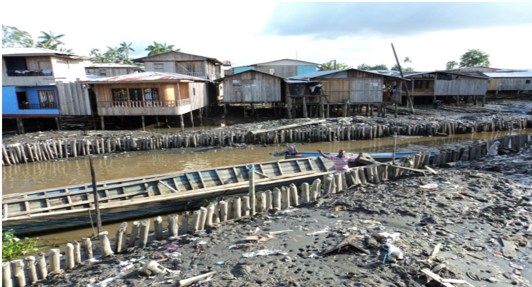
Figura 49. Infraestructura afectada sub-zona 4 márgenes de la quebrada Mariquita municipio de Olaya Herrera
