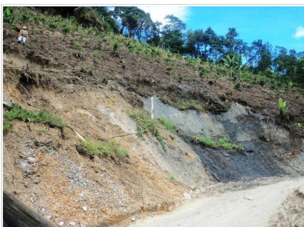
Fotografía 57. Panorámica del deslizamiento en dirección NW – SE. EVENTO 17. Vereda Chapiurco.
