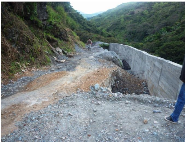
Fotografía 39. EVENTO 35. El deslizamiento se encuentra en estado suspendido. Según morfometría del evento la masa desplazada es de 1.350 m 3 , área afectada 1.850 m 2
