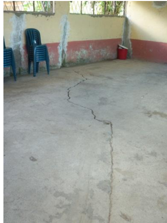
Fotografía 53. Vista interna del área de comedor. Se presenta fisuración de muros y pisos de la Institución Educativa Chapiurco.
