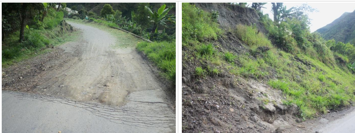
Fotografía 17 y 18. EVENTO 33. Detalles de la afectación de la banca y de la ladera. Se observó la presencia de esquistos grafiticos muy fracturados y de textura foliar.
