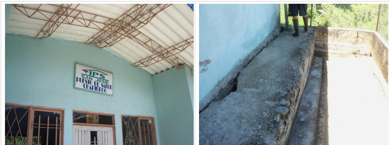
Fotografías 50 y 51. Puesto de Salud Chapiurco. La construcción presenta fisuramiento en muros y andenes perimetrales.
