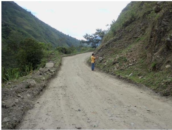
Fotografía 31. Panorámica en dirección S – N. EVENTO 28. El evento presenta un volumen deslizado de 2.180 \text{ m}^3 , y una afectación correspondiente a un área de 4.300 \text{ m}^2
