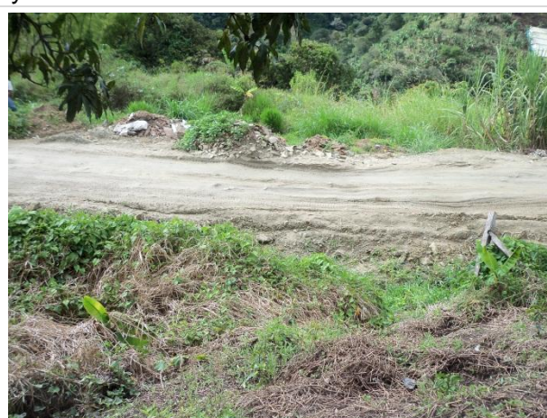
Fotografía 78. Panorámica en dirección E-W. EVENTO 09. Hundimiento de la banca.
