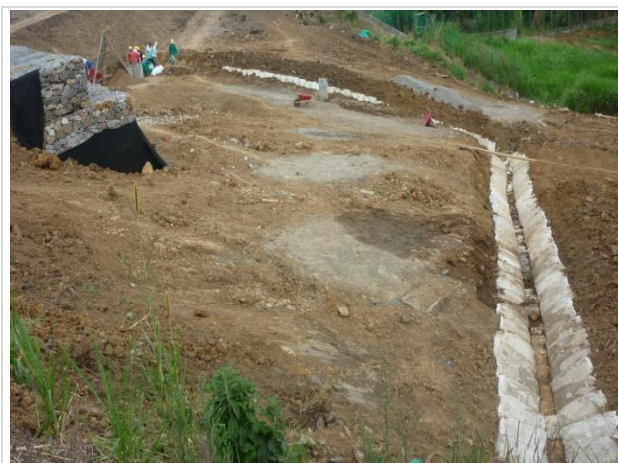
Fotografía 75. Canales de drenaje en sección trapezoidal, contruidos con sacas y suelo cemento (8:1).
