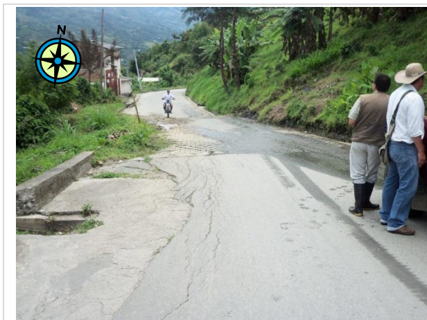
Fotografía 03. Vista panorámica en el sentido S-N, indica la afectación de la banca en el sector del Carmelo.
