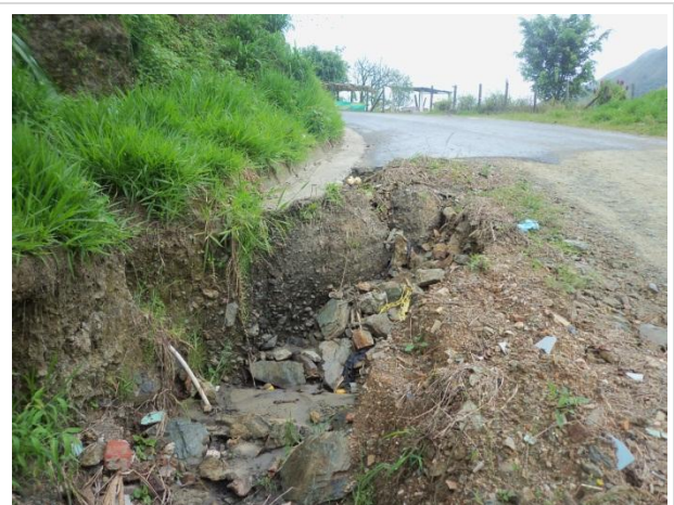
Fotografía 10. EVENTO 08. Indica el asentamiento de la banca de la vía en el sector.
