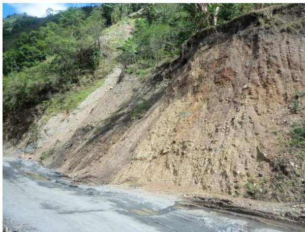
Fotografía 66. Panorámica del talud en dirección S – N. EVENTO 02.
