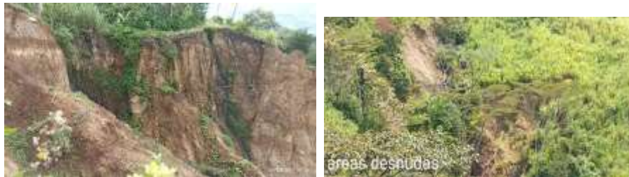
Figura 47 Cobertura de deslizamiento identificado en la vía que comunica la vereda El Hatillo con La Planeta.
