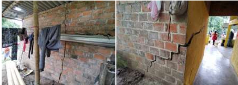
Figura 84 Registro fotográfico que evidencia las afectaciones en las viviendas de la vereda La Planeta.
