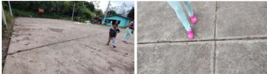
Figura 85 Hundimiento y separación de baldosas en la cancha para deporte.
