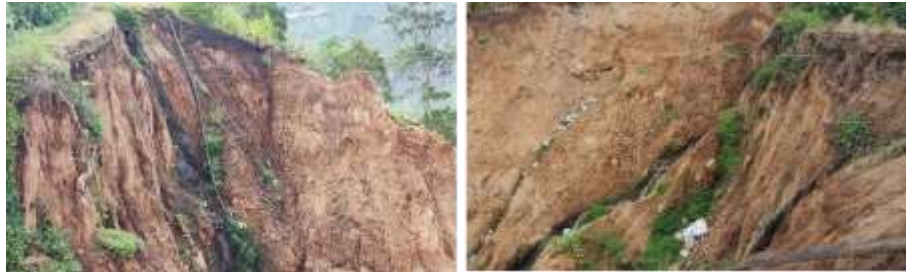
Figura 88 Vertimientos sobre la ladera y saturación del suelo.
