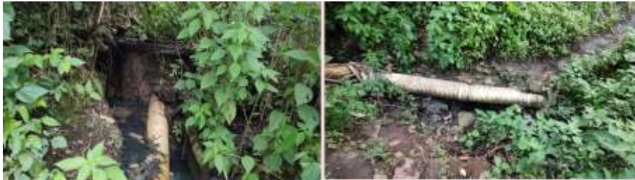
Figura 86 Cámara de agua en inadecuadas condiciones.
