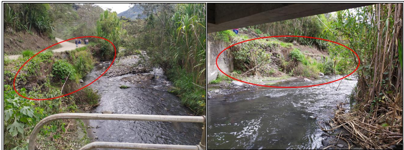
Figura 7. Talud del río que soporta la vía y muro de contención con socavación fluvial.
