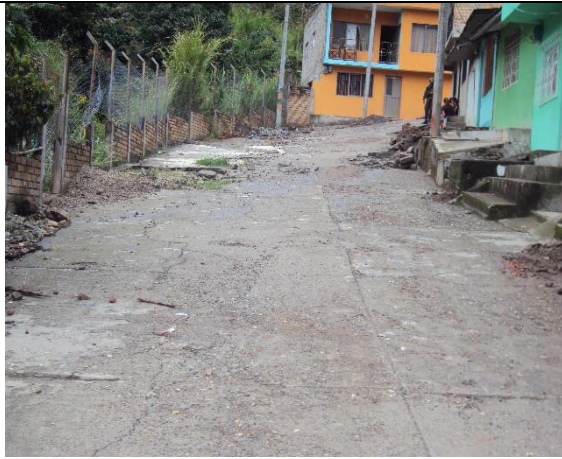
Evento 41. Fisuras longitudinales sobre la vía.
