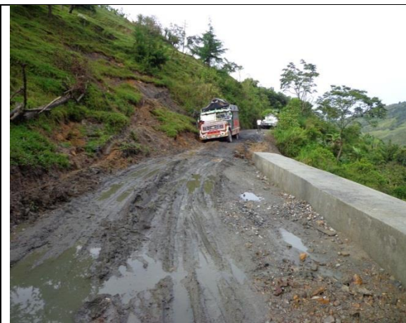
Evento 34. Afloramiento de aguas subterráneas.
