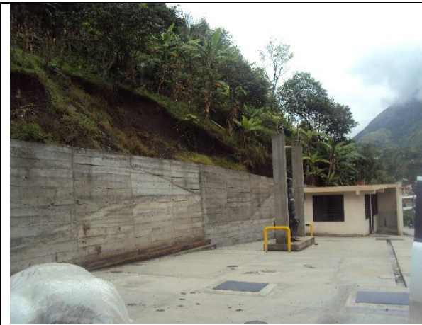
Evento 42. Caída de roca.
