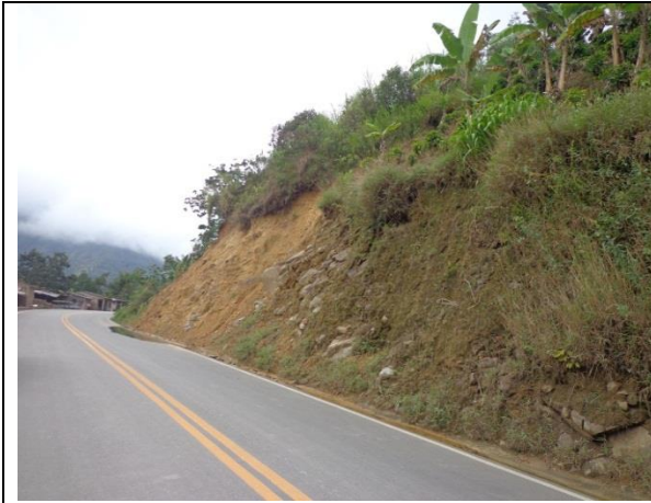
Evento 26. Deslizamiento rotacional.
