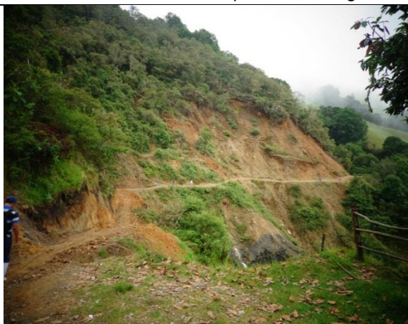
Evento 10. Vía incomunicada y en mal estado.
