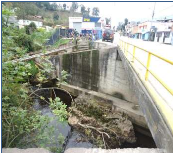
Figura 43. Puente sector El Encano, destruido anteriormente por avenida torrencial.
