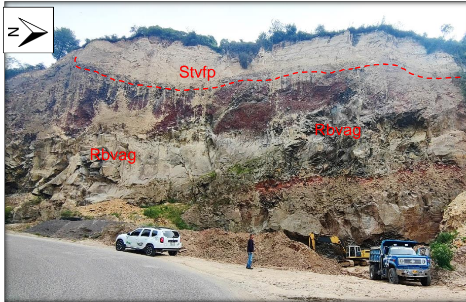
Figura 14 Extracción de materiales de construcción en el municipio de Potosí (coordenadas: 0°48'21.25"N, 77°34'44.04"W), se identifican unidades de Rocas diaclasadas de origen ígneo volcánico de las Andesitas del Guáitara (Rbvag), Suelos transportados volcánico de flujos piroclásticos (Stvfp); geomorfológicamente se encuentra en Escarpes de flujo piroclástico aterrazado (Vfpe).
