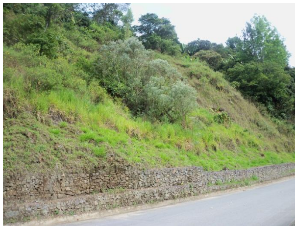
Fotografía 81. Vista en sentido NW-SE. EVENTO 12.
