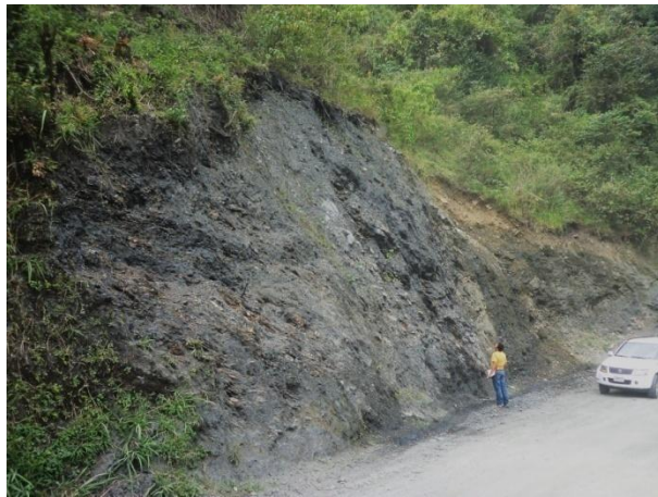
Fotografía 37. Panorámica en dirección NW – SE. EVENTO 33. Tiene una altura de corona de 15.0 m, un ancho promedio de masa deslizada de 52.0 m, genero un volumen deslizado de 832.0 m 3 .
