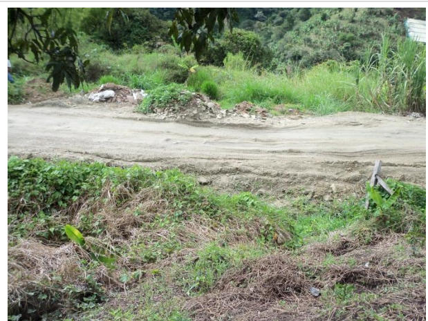
Fotografía 12. Panorámica en dirección E-W. EVENTO 09. Hundimiento de la banca.
