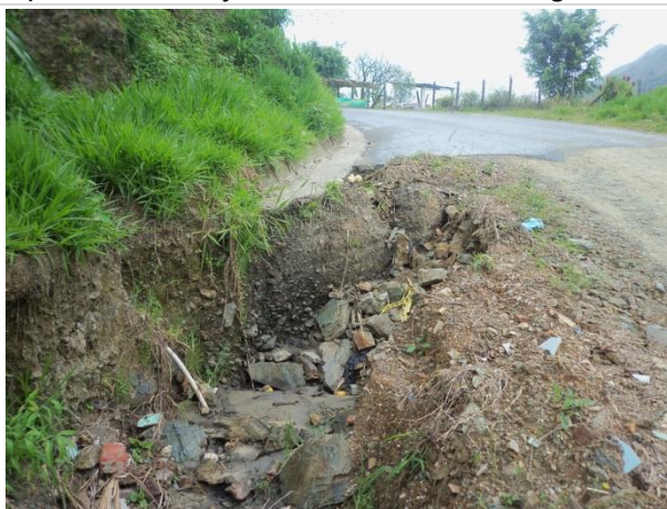
Fotografía 77. EVENTO 08. Indica el asentamiento de la banca de la vía en el sector. (a= 0.65 m)
