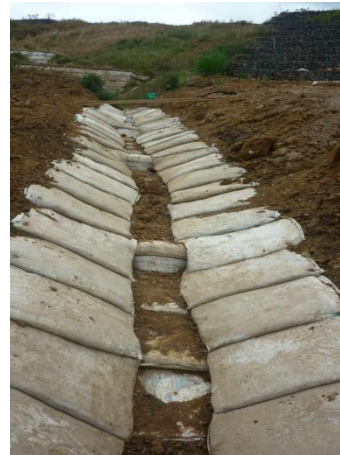
Fotografía 76. Detalle de los disipadores con espaciamiento de 5.0 m
