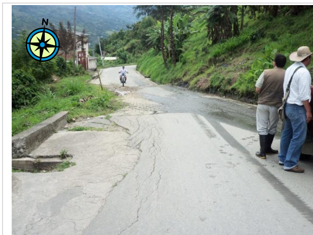
Fotografía 03. Vista panorámica en el sentido S-N, indica la afectación de la banca en el sector del Carmelo.
