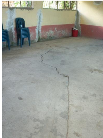
Fotografía 53. Vista interna del área de comedor. Se presenta fisuración de muros y pisos de la Institución Educativa Chapiurco.
