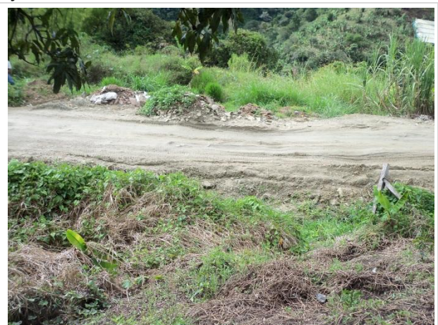
Fotografía 78. Panorámica en dirección E-W. EVENTO 09. Hundimiento de la banca.
