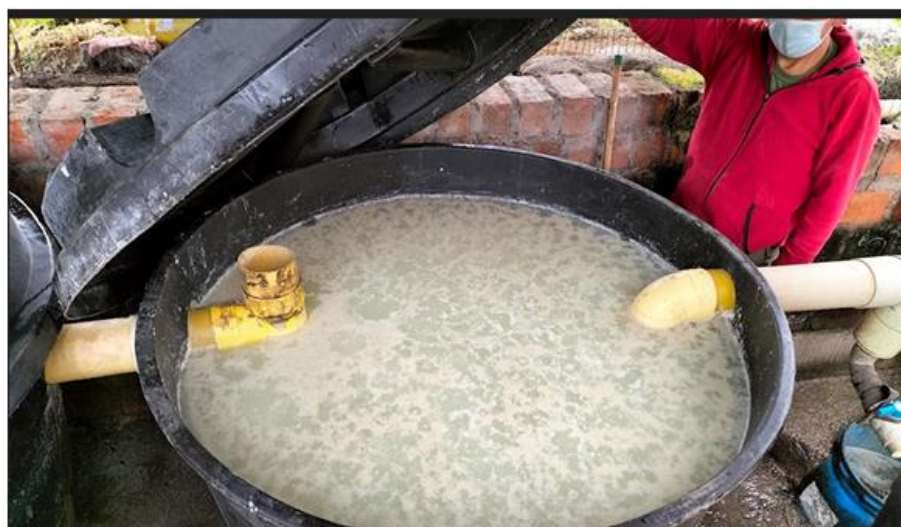
Fotografía 5. Presencia de grasas en el FAFA
