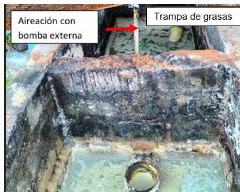
Fotografía 4. Componente trampa de grasas
