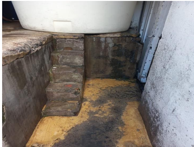
Fotografía 3. Desperdicios de agua potable
