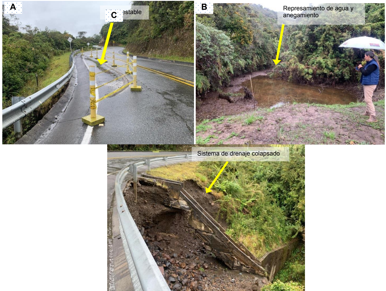
Figura 6. A. Vía inestable. B. Represamiento de agua. C. Sistema de drenaje colapsado Coordenadas Geográficas: A-B-C. (1° 9' 4,845" N- 77° 7' 41,365" W)
