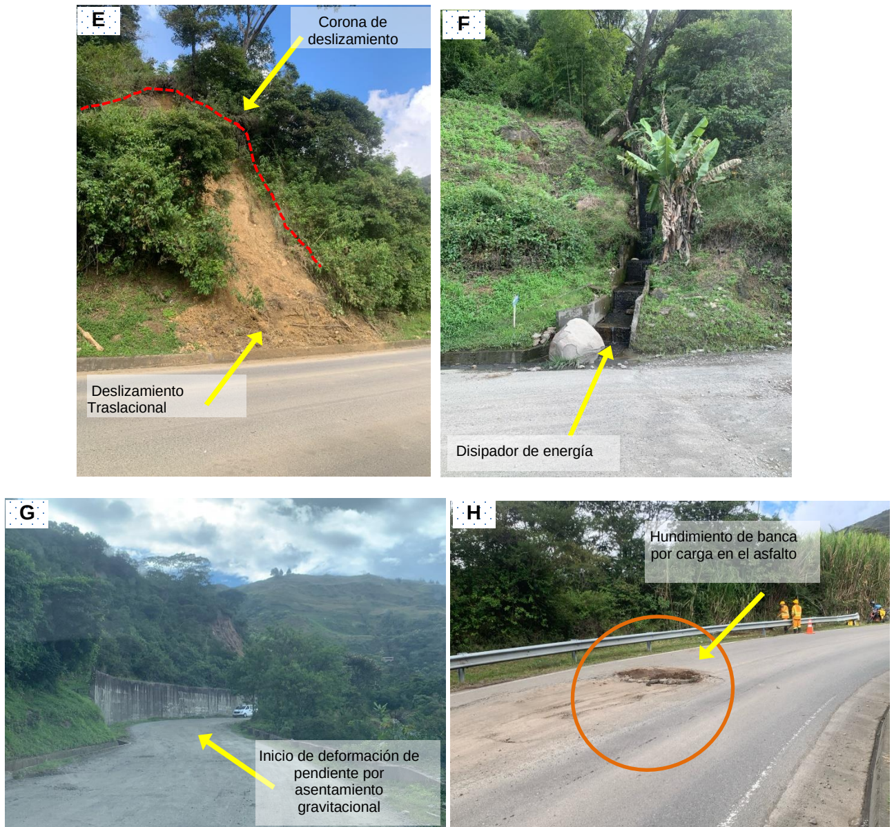
Figura 8. A. Inicio de deformación de pendiente por asentamiento gravitacional. B. Fin de deformación de pendiente por asentamiento gravitacional. C. Perdida de banca. D. sedimentos de diferentes tamaños. E. Corona de deslizamiento-Deslizamiento Traslacional. F. Disipador de energía. G. Inicio de deformación de pendiente por asentamiento gravitacional. H. Hundimiento de banca por carga en el asfalto.
