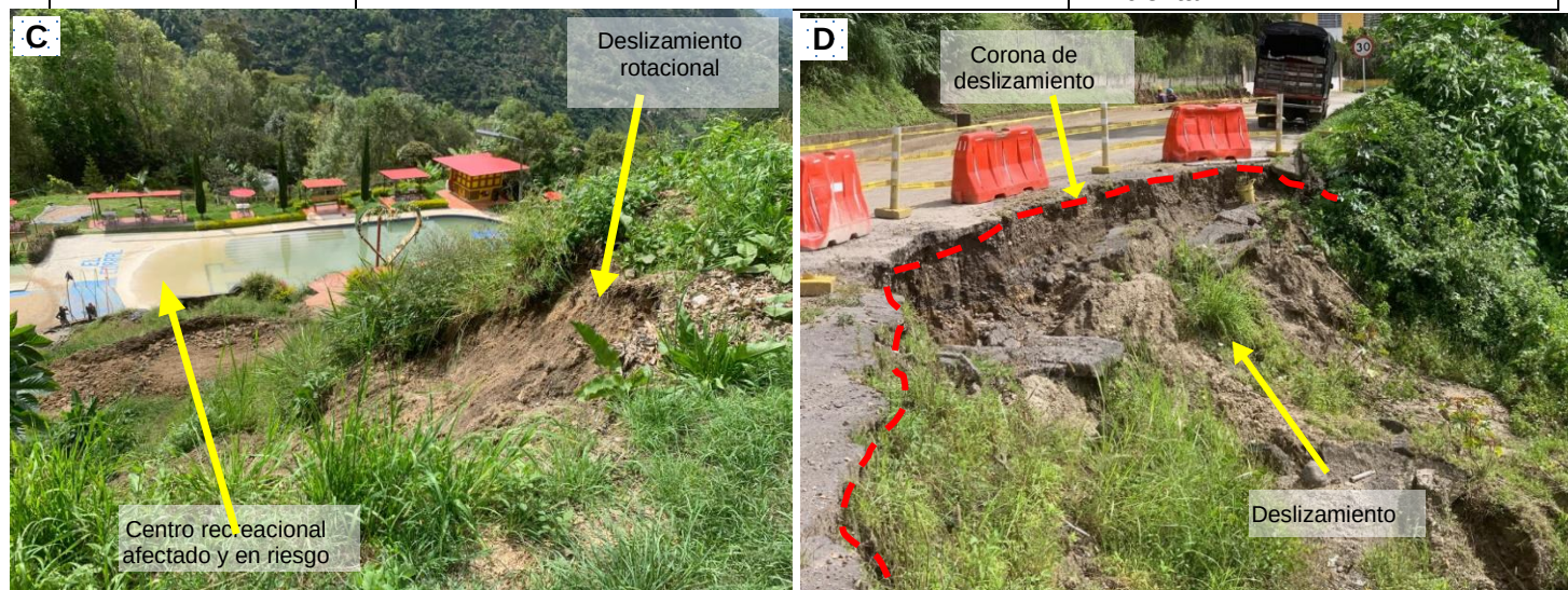
Figura 7. A Quebrada adyacente al deslizamiento. B. Perdida de banca. C. Deslizamiento rotacional- Centro recreacional afectado y en riesgo. D. Corona- deslizamiento.
