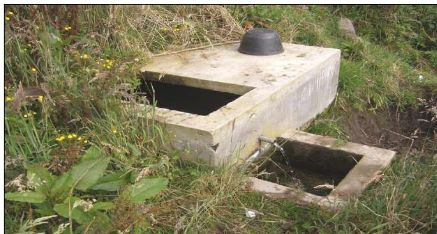
Figura 462. Estructura de bocatoma y tanque, acueducto vereda Chorrera Negra, municipio de El Contadero, Altura: 3.088 m.s.n.m.
