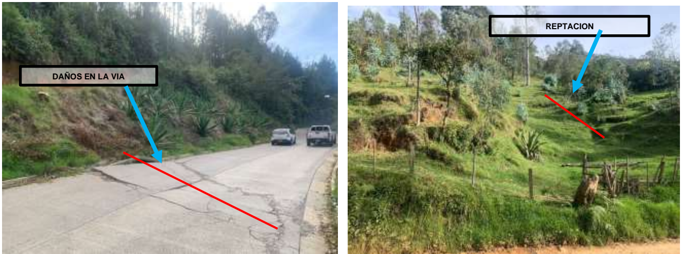
Figura 1. A. Daños en la vía (Punto 1) – B. Reptación (Punto 2) C. Deslizamiento Rotacional (Punto 4) D. Deslizamiento Rotacional (Punto 6)
