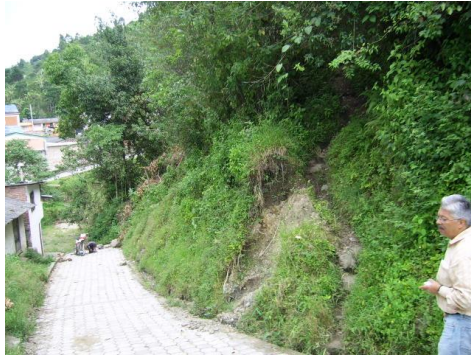
Fotografía 1. Panorámica del movimiento de remoción en masa, observar como el cuerpo del deslizamiento obstaculiza las cunetas de la vía.
