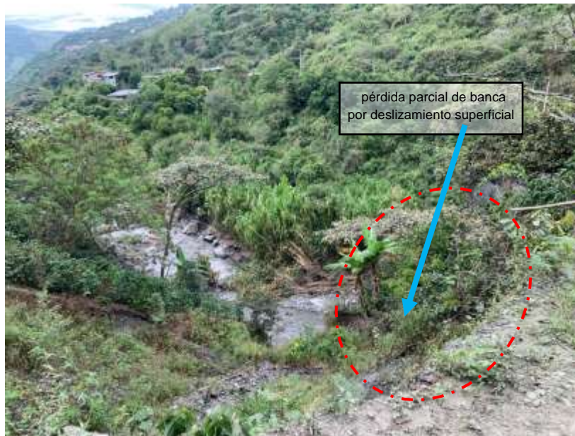
Zona que presenta, Perdida de banca por deslizamiento superficial
