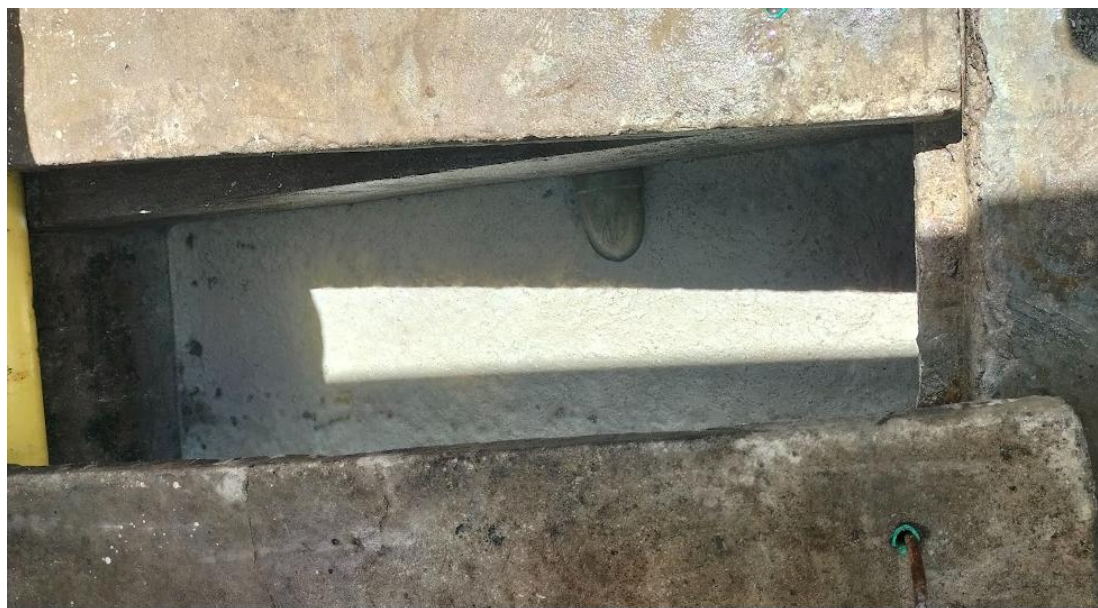
Fotografía 1. Caja de recolección de agua residual no domestica
